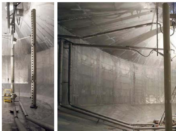
Schichtbeladeeinrichtung eines Wärmespeichers
